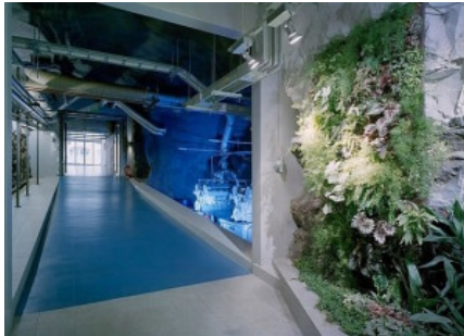
Corridor Serverpark met (koeling en Generatoren)
