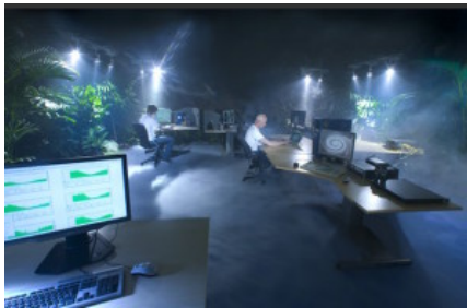
In het Datacenter worden alle verbindingen continue gemonitord
