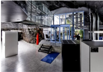
Kabelbomen (rechts) naar de Satteliet straat verbindingen en onderzee-glasfiberskabels
